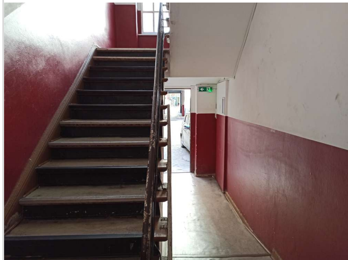
Treppenhaus ohne Aufzug
